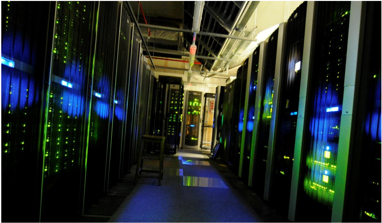
Serverroom voor opslag van digitale informatie
